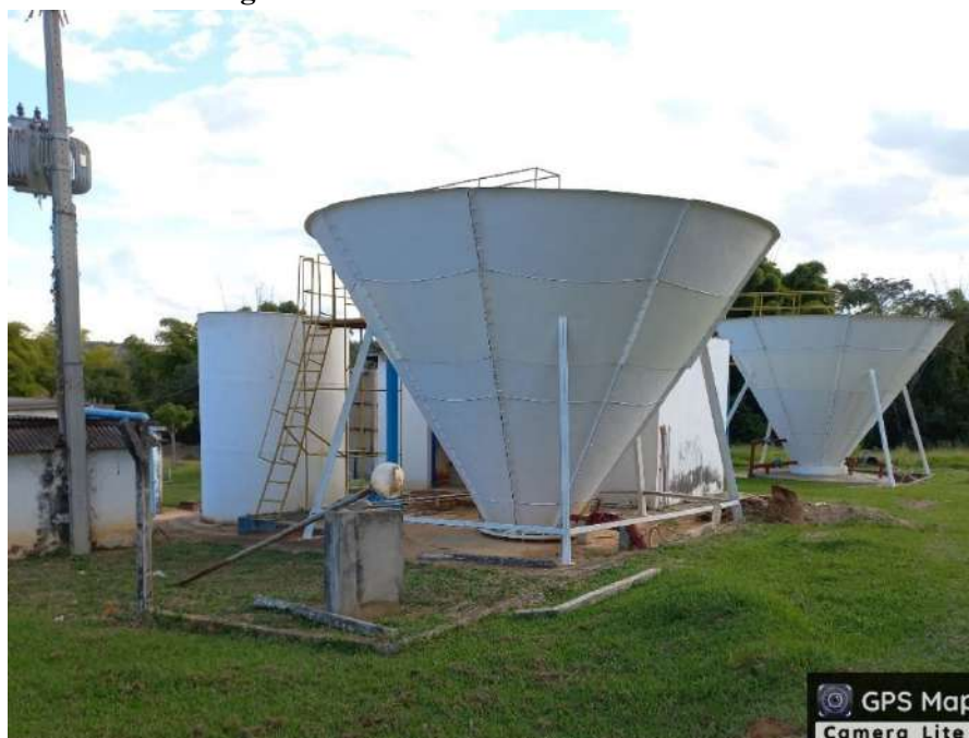
Figura 28 - Decantadores e filtros.
