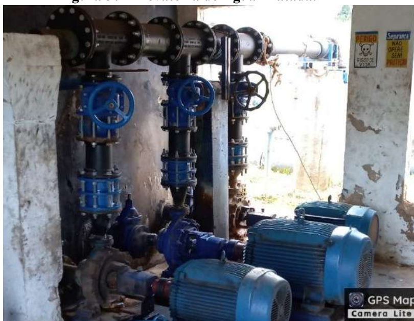
Figura 30 - Elevatória de Água Tratada.
